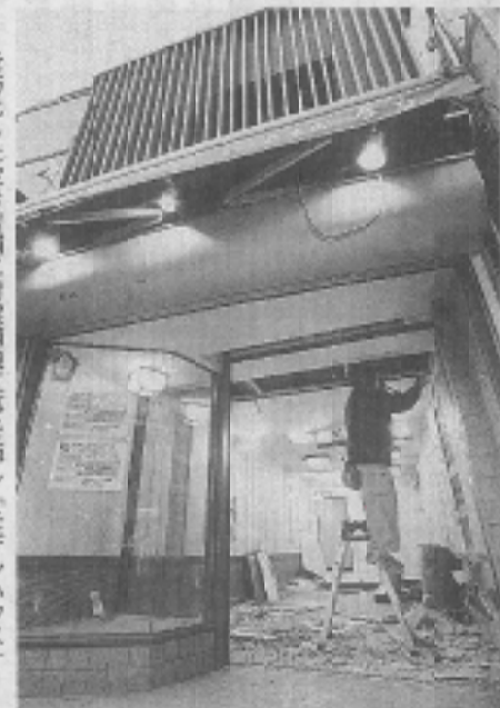
老朽化した空き店舗に耐震補強工事を施し「モデルハウス」
